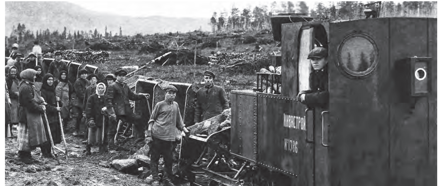
▲ Нива ГЭС-2. Подготовка строительной площадки Niva HPP-2. Development of the construction site
