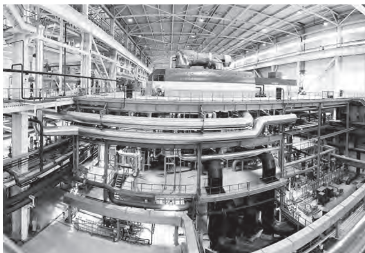
◀ Правобережная ТЭЦ. Машинный зал нового энергоблока Pravoberezhnaya CHPP. Turbine hall of a new power generating unit
