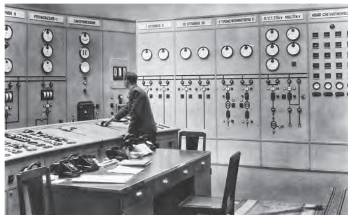
▶ Главный пульт управления Роухиала (Лесогорской) ГЭС Main control panel at Rouhiala (Lesogorskaya) HPP
