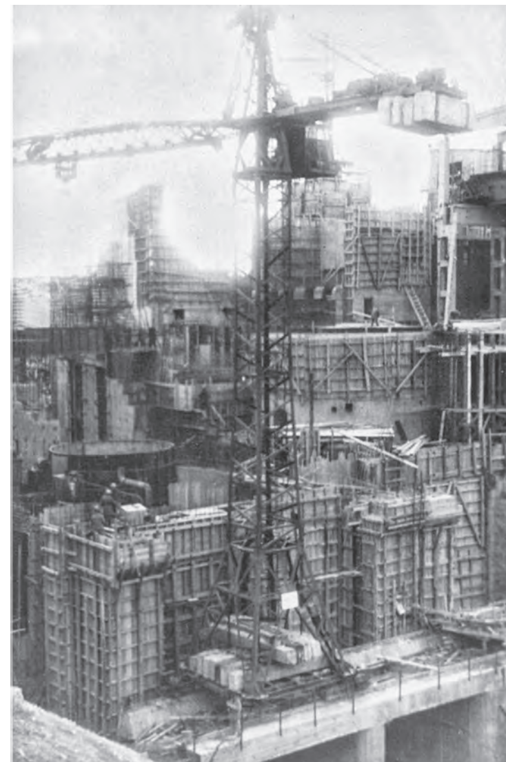
Путкинская ГЭС. ▶ Панорама строительства Putkinskaya HPP. Panoramic view over the construction site
