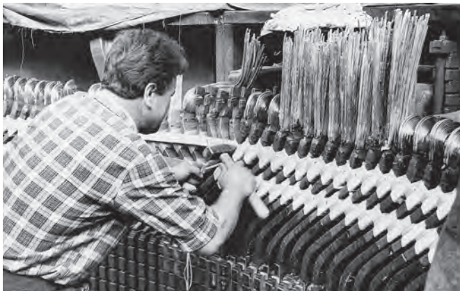
Серебрянская ГЭС-1. ▶ Монтаж электротехнического оборудования Serebryanskaya HPP-1. Assembly of electro technical equipment
