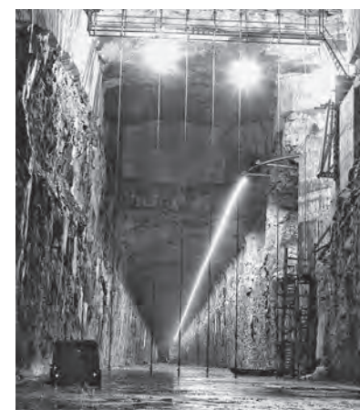
◀ Верхне-Тулумская ГЭС. Нижний бьеф. Электрические тросы для отпугивания лосося Verkhne-Tulomskaya HPP. Downstream. Electric cables for hazing salmon
