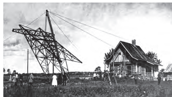
Волховская ГЭС: установка опор на первой линии электропередачи (ЛЭП) 110 кВ Волхов — Ленинград Volkhovskaya HPP: pole installation on the first 110 kV electricity transmission line connecting Volkhov and Leningrad
