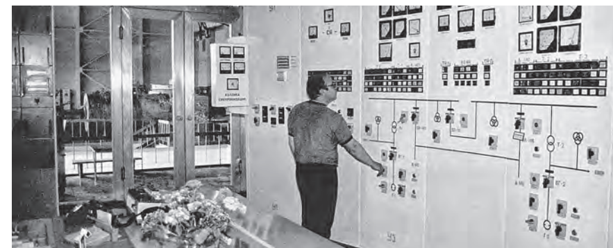
Кривопорожская ГЭС. Главный пульт управления ▶ Krivoporozhskaya HPP. Main control panel
