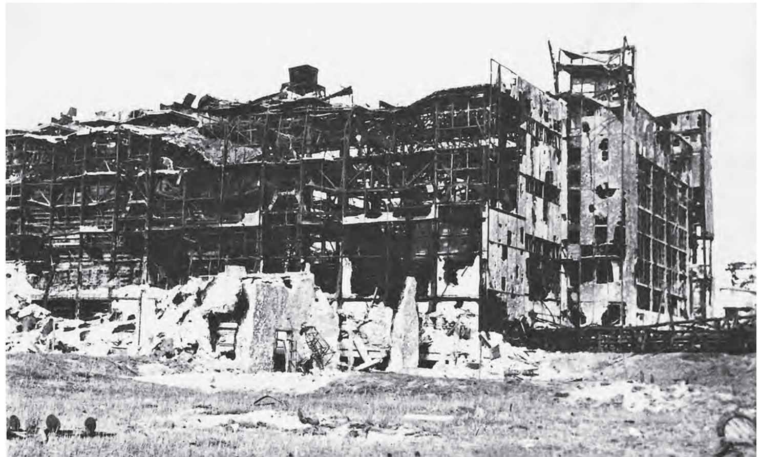
В феврале под Ленинградом отвоевана Дубровская ГРЭС-8 — с осени 1941-го немецкие войска использовали ее как укрепленный оборонительный рубеж. В ходе военных действий рабочий поселок и станция оказались полностью разрушены In February, Dubrovskaya GRES-8 near Leningrad was won back; beginning in autumn 1941, the German Army used it as a reinforced defense perimeter. The workers' camp and the power plant were completely destroyed during military action
