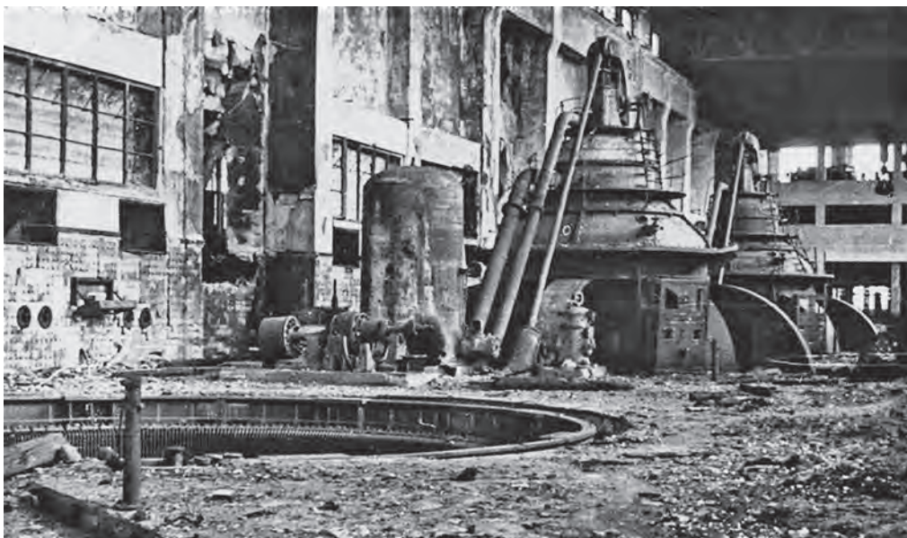
◀ Турбинный зал Нижне-Свирской ГЭС Turbine hall at Nizhne-Svirskaya HPP
