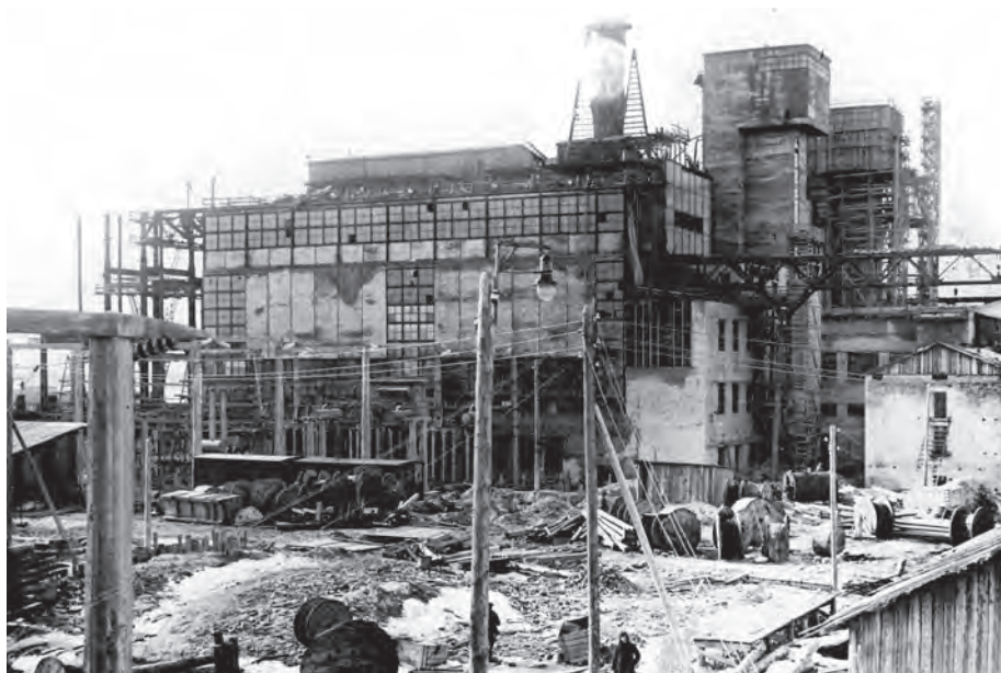
«Невдубстрой», вид станции с восточной стороны Nevdubstroy, eastern view of the power plant
