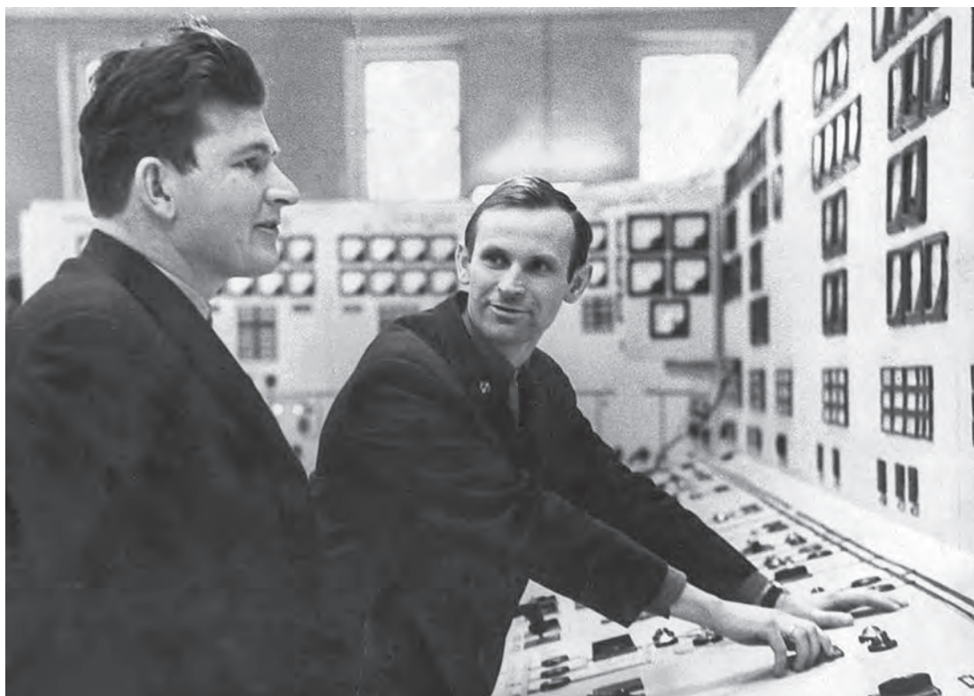
Кировская ГРЭС. Главный щит управления Kirovskaya GRES. Main control panel
